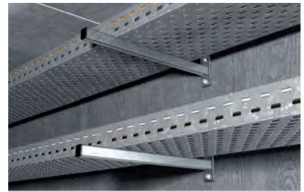
Kabeltrasse auf Auslegerkonsolen
